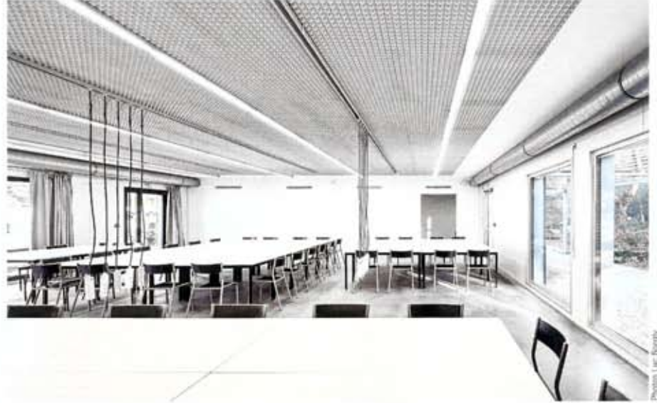
La distribution électrique par perches mobiles assure la polyvalence des espaces de travail.
